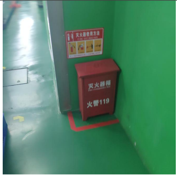
车间内灭火器
