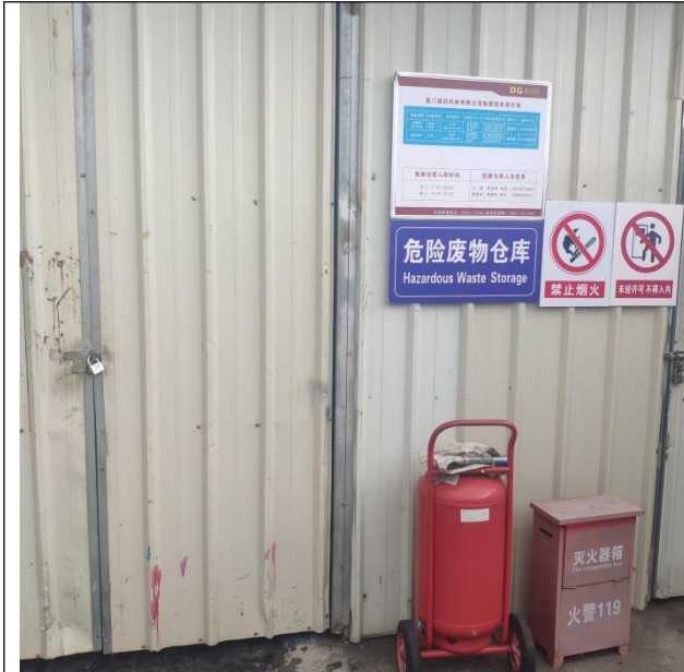
危险废物仓库灭火器
