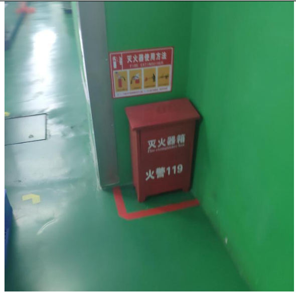
车间内灭火器
